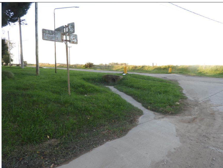
Desagüe de calle La Madrid bis (insuficiente)
