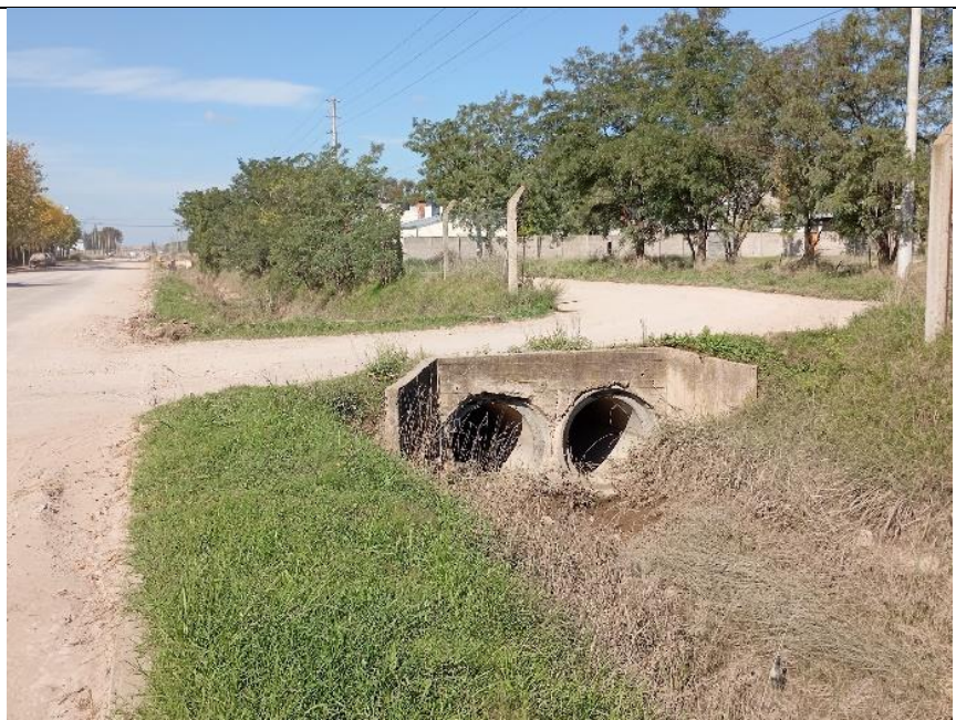
Canal de Avenida Olavarría, primer acceso a Barrio Islas Malvinas (dos tubos de 1,00 m de diámetro)
