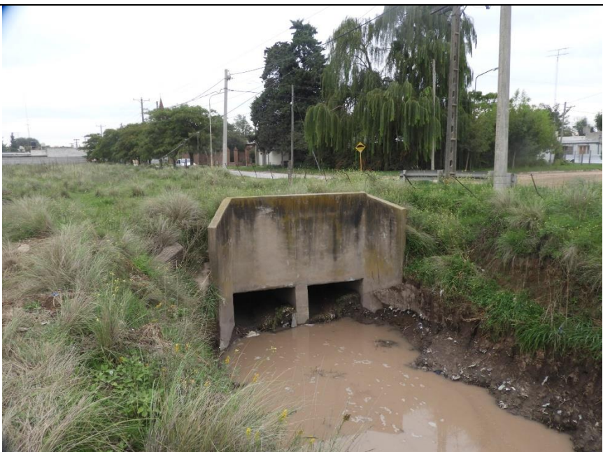
Boca de salida del canal de calle Juncal -ahora en calle Fundadores- en Santa Trinidad (nótese la acumulación de sedimentos en el interior)
