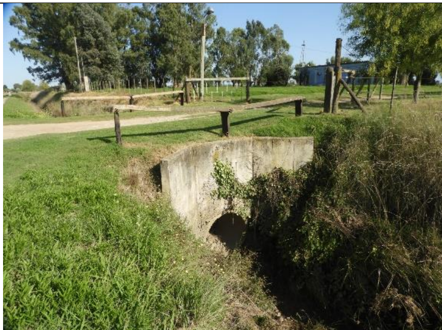
Canal abierto de Avenida Alfonsina Storni, acceso a Escuela Agropecuaria (tubo de 1,18 m de diámetro)
