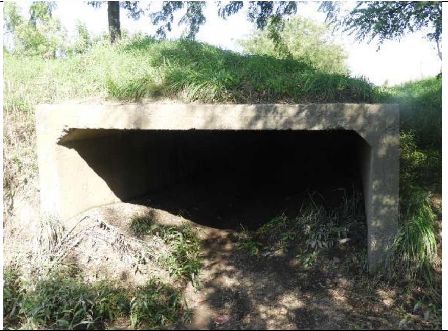
Boca de salida del canal cerrado de Avenida Alfonsina Storni, con acumulación de sedimentos (medida: 2,80 m por 1,40 m)
